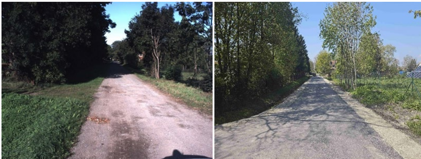
Remont nawierzchni odcinka drogi gminnej nr 101005N o dł. ok. 220 mb w m. Władysławowo. Koszt zadania: 281.176 zł. (Nawierzchnia bitumiczna)
